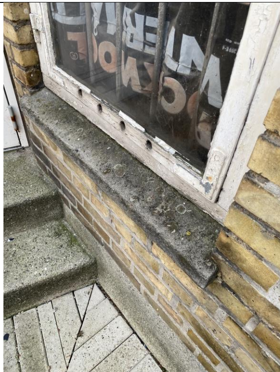
Støbte sålbænke, overflade forvitret
