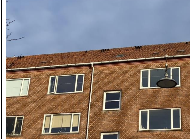
Facade mod gade, tagbelægning ses også at løftet sig grundet gentagne understrygninger
