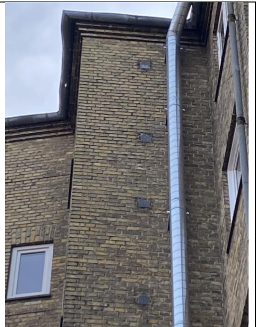
Gårdfacade, gamle udluftninger til fadebure og revnede fuger
