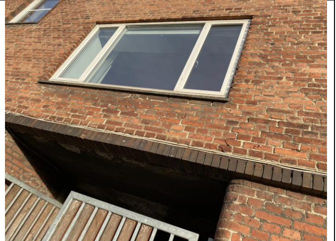
Mursten skubbet ud ved jern over port, fuger at have revnede.
