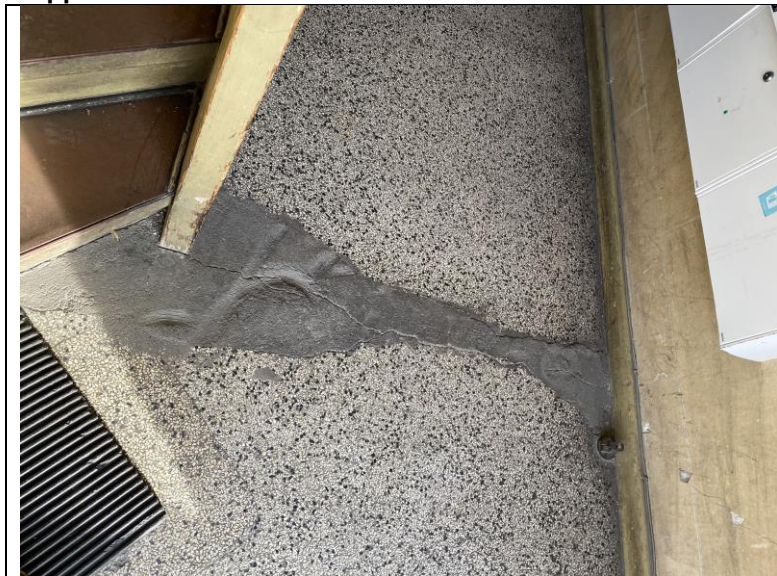
Terrazzo revnet over bærejern og søgt repareret
