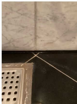
Fuge i brusekabine er fuget om imellem væg og gulv
