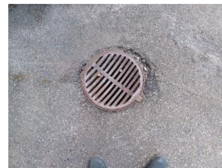
Overfladerist i gård
