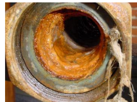
Eksempel på biofilm med slimdannelse i vandrør
