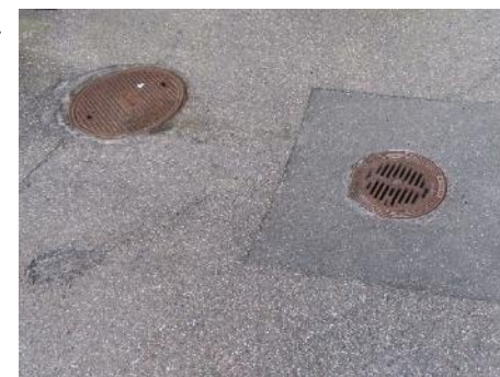
Kloakbrønd og overfladerist i gård
