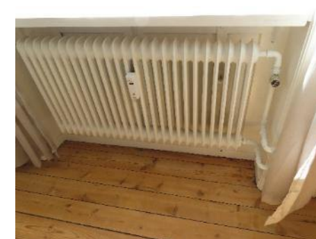
Radiator i lejlighed
