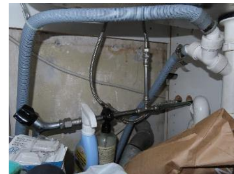
Vandinstallation i kælder
