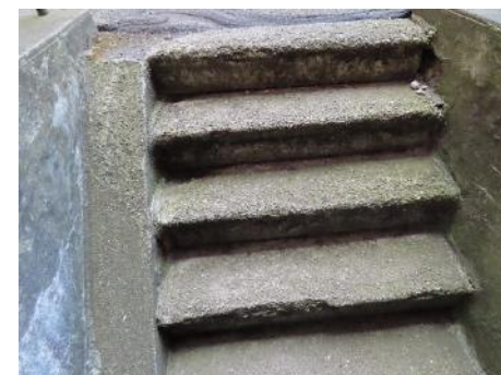
Betontrappe med udvasket beton og afslag på trinfor-kanter
