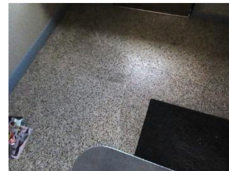
Indgangsrepos med revner
