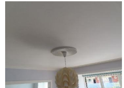
Loft uden revner
