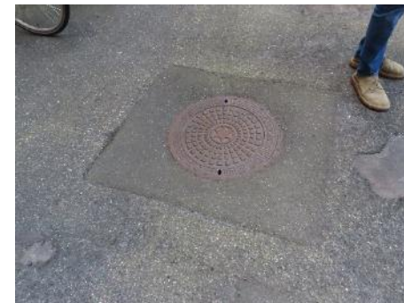
Kloakbrønd i gård
