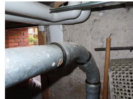
Tæring på afløbsrør i kælder
