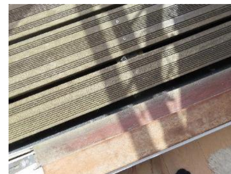
Der bør renses regelmæssigt under terrassebrædderne på tagaltaner
