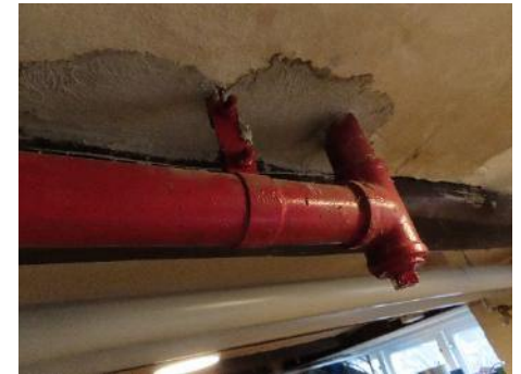
Gasrør i kælder
