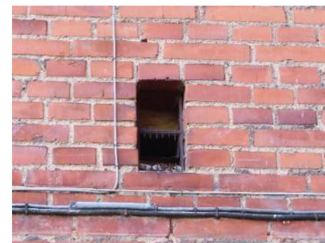
Manglende rist ved fadebur/svaleskab
