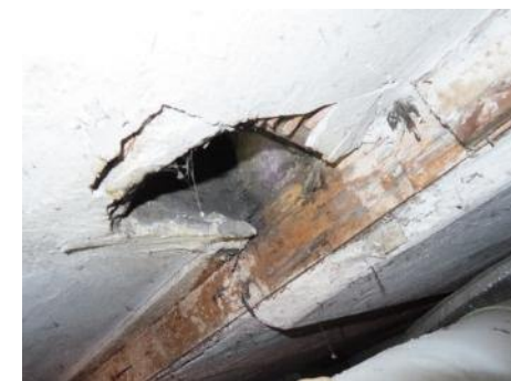
Ventilationskanal i kælder
