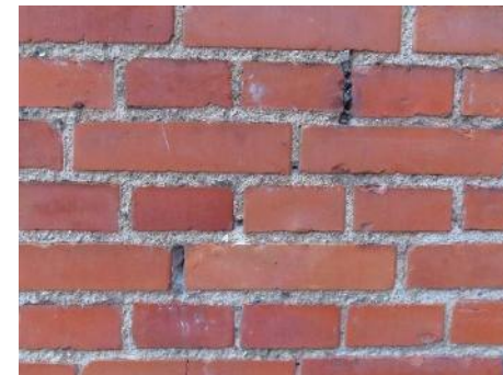
Manglede fuger i murværk
