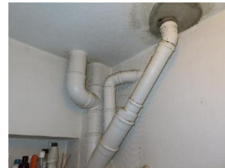
Faldstamme i toilet
