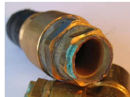
Eksempel spændingskorrosion i messingfitting
