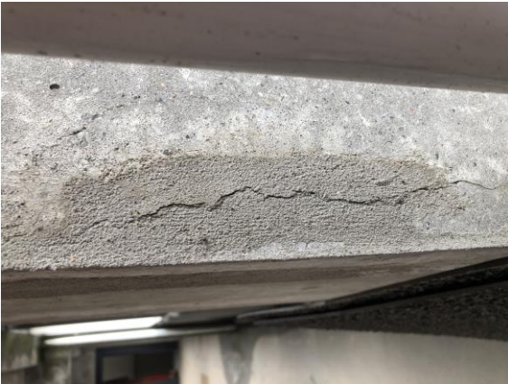
Altangang 4.sal . Midtersøjle med tæringsrevner
