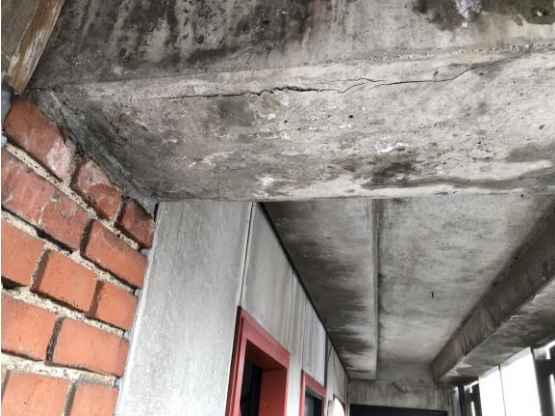
Altangang 4.sal . Midterbjælke med tæringsrevner
