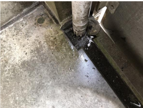
Altangang 3.sal . Midtersøjle med tilstoppet regnvandsafløb og som følge heraf en kraftig op fugtning af betonkonstruktionen
