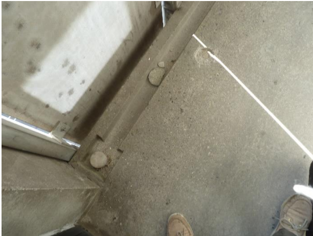
Afvandingsrene præget i betonelementet. Ved stopning sker der overløb. Huller efter kran-huller blottes når tilstøbninger springer af.
