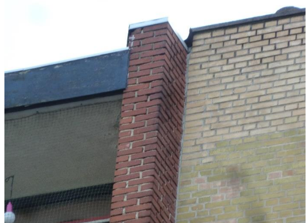
Murværk brandskel med udvaskede fuger. Stærn med afskallinger.
