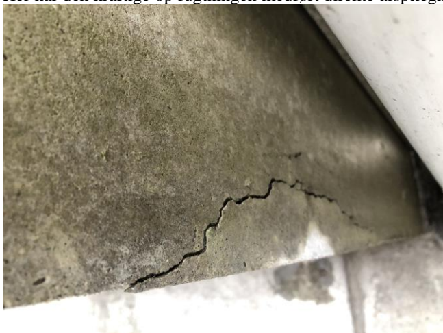
Altangang 2.sal Her ses en tæring der vil medføre at et stykke af betonsøjlen er ved at løbe sig.
