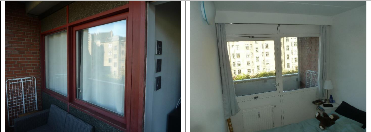
Mod gården snedkerpartier som til gaden, her med drejevinduer. I ok stand men skal eftergås og malerbehandles. Alle termoruder burde skiftes til moderne lavenergi.
