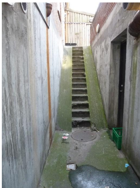
Udvendig nedgang fra gård til kælder. Benyttes bl.a. for cykler. Almindeligt vedligehold af betonfladerne påkrævet.
