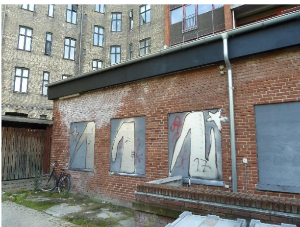
Blændede erhvervsvinduer med graffiti. Nye render og nedløb her.
