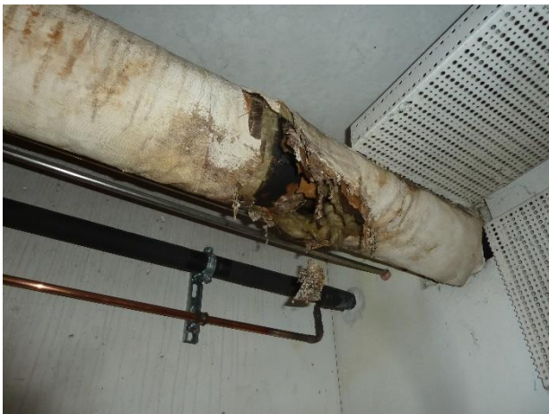
Isolering defekt. Lettere rustskader ses.
