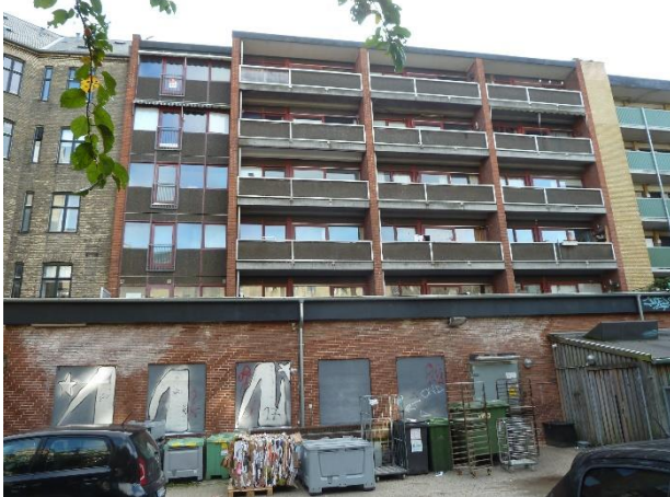
Gårdfacade. Nedre del ved fremskudt erhverv er med saltskader fra tidligere utætheder.
