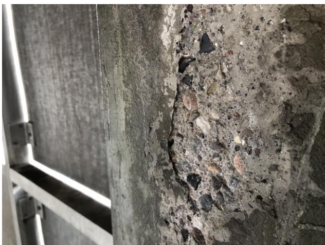
Altangang 3. sal Her har den kraftige op fugtningen medført direkte afspærgning af det dækkende betonlag
