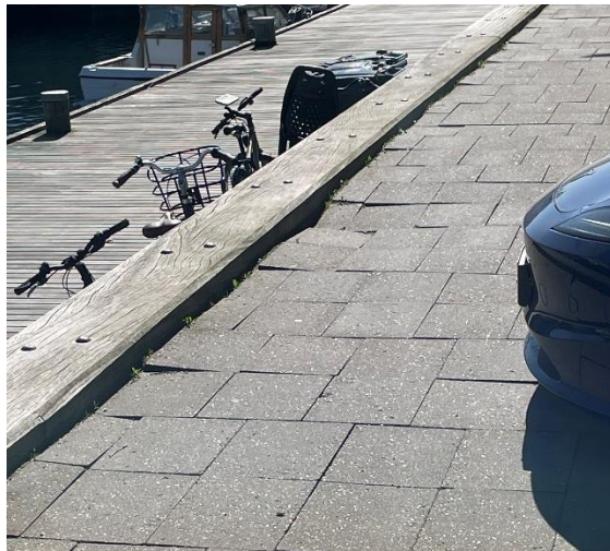
Belægnings sten er sunket langs hammer
