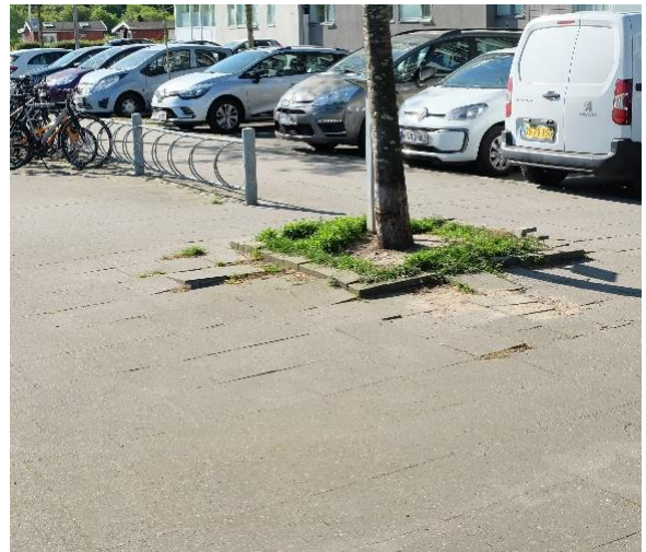
Belægnings sten løftet grundet rødder
