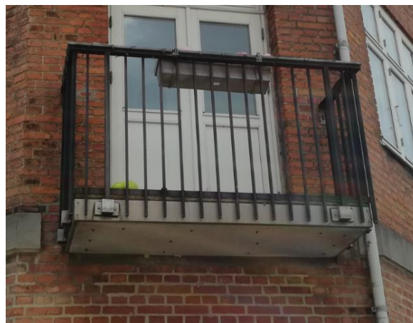
Fugt på murværk under altan
