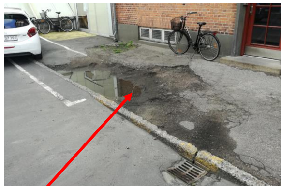
Asfalt helt væk
