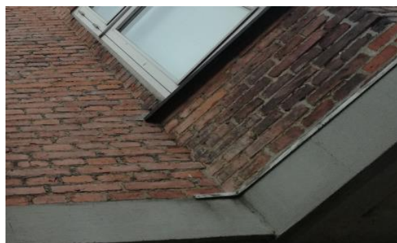
Slidte fuger på overmur
