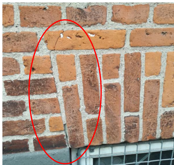
Sætningsskade i murstik
