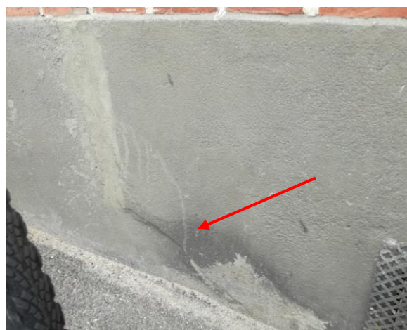
Sætningsrevne på offersokkel
