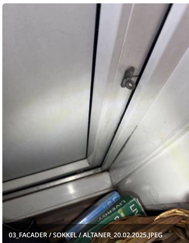
Skimmeldannelse ved Altandør
