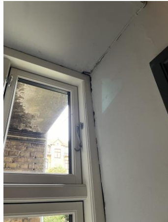
Foto 9 - manglende fuger efter montering af vindue (bitrappel)
