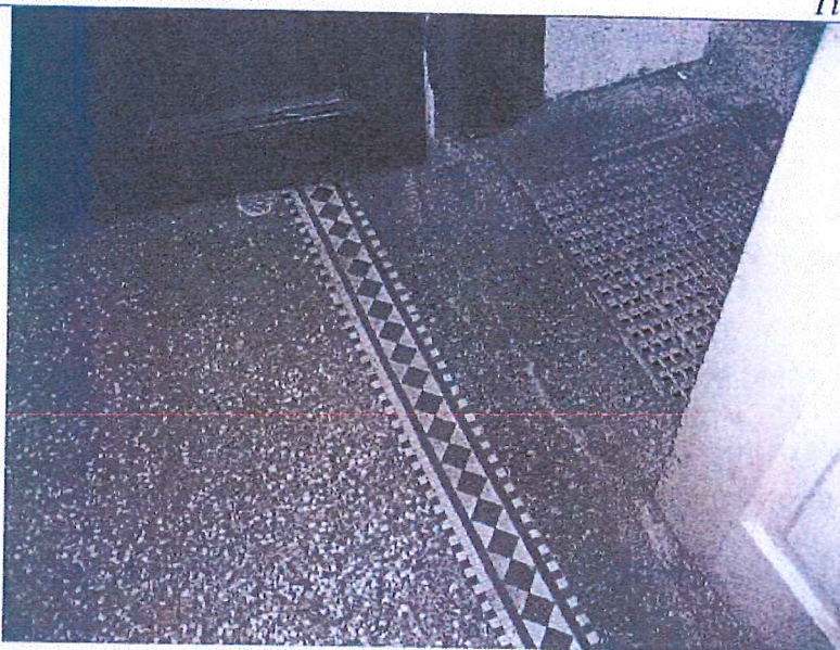
Revner i terrazzobelægning i indgangsrepos
