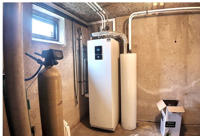
Nyt Luft/Vand varmesystem
