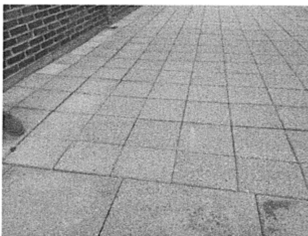
Ujævn flisebelægning ved repos uden fugesand
