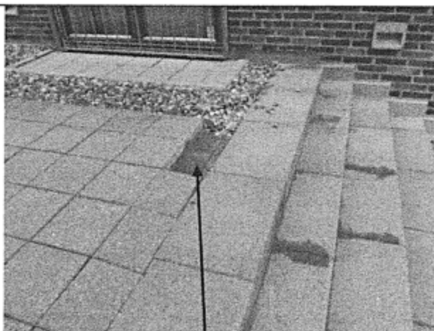
Flise mangler ved repos
