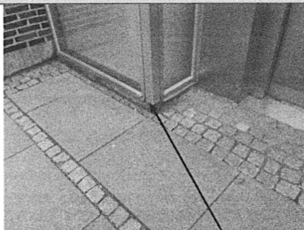
Skader på sokkel ved indgangspartier
