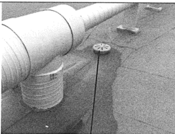
Tagbrønd med ventilation
