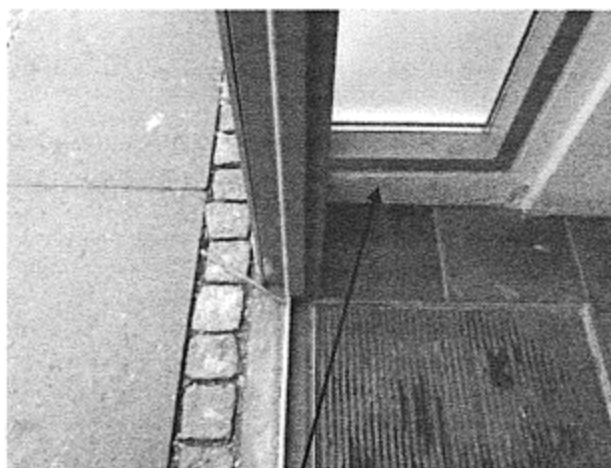
Fugtskade ved hoveddør
